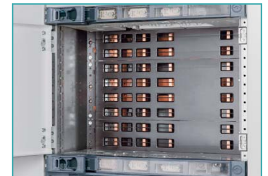
System szyn dystrybucyjnych, zabezpieczony przed przypadkowym dotknięciem (IP20B)
